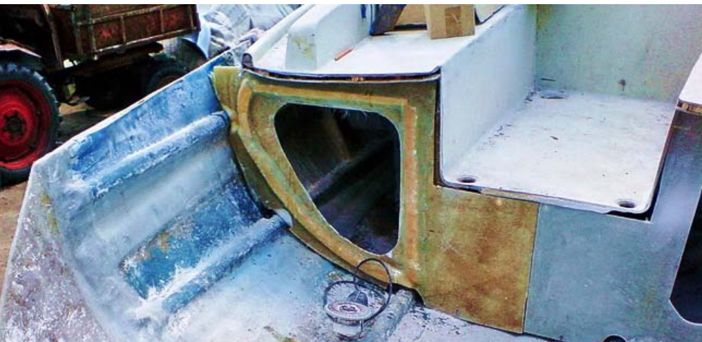
Посмотрите, во что превратилась трехслойная конструкция яхты Польского изготовления через 12 лет службы
